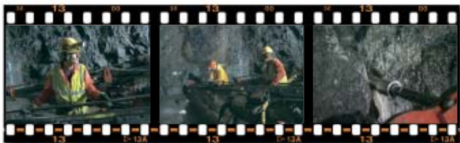
Injektointiporareivät ovat 22 metriä pitkiä, joten porauskalustoa täytyy jatkaa niin sanotuilla jatkotangoilla. Tankojen asentamisen jälkeen päästään tekemään itse injektointiporausta.
